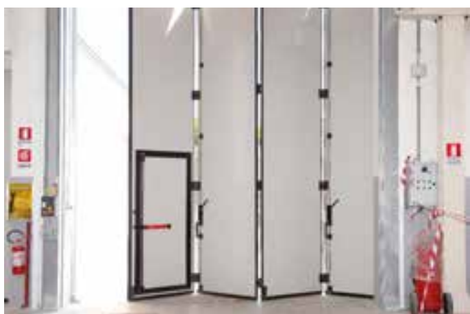
Modello 4+0 SGP vista interna, senza oblò, porta pedonale con scalino/ingombro inferiore non adatto come uscita di sicurezza.
